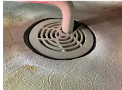
Belegg er utett rundt sluk, ikke lagt inn under klemring.
