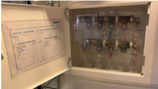
Fordelerskap på loftet
