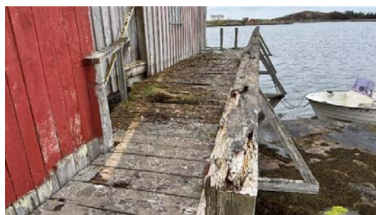
Kai/brygge i treverk i dårlig forfatning.
