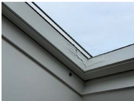
Eksempel på skade i vinduskarm.
