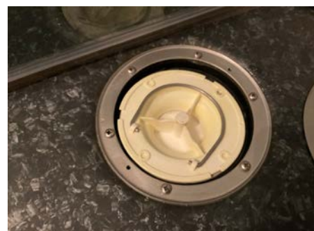
Sluk, synlig membran klemt under klemringen.
