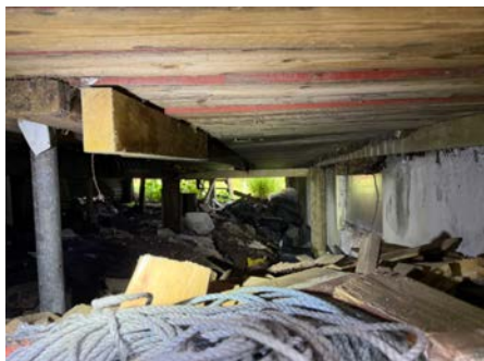
En del nedbøying i gulvbjelke.
