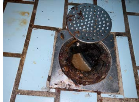
Sluk av støpejern fra byggeår.
