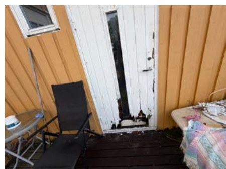
Store råteskader på døren til boden på veranda.
