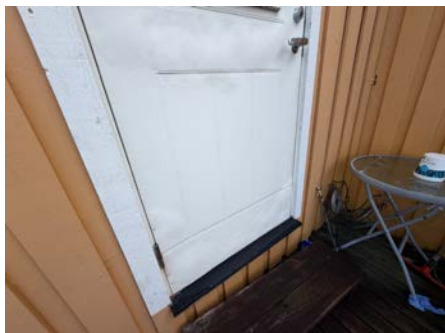
Fukskadet ytterdør inn til soverom.
