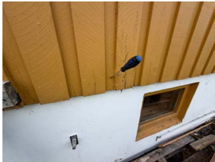
Råteskadet bordkledning, omfanget er fr
