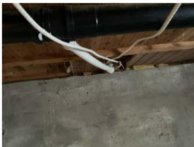
Ikke fagmessig utførelse av vannledninger/fordelingsanlegg.
