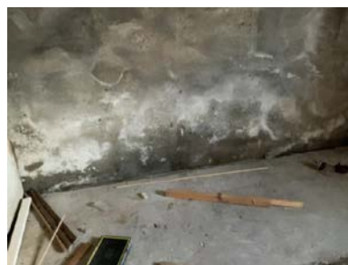
Salt/kalkutslag på grunnmur mot terreng grunnet fuktvandring gjennom vegg.
