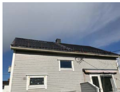
Taksider mot syd, en del plater er skiftet grunnet skade.
