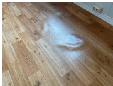
Løst belegg på kjøkken.
