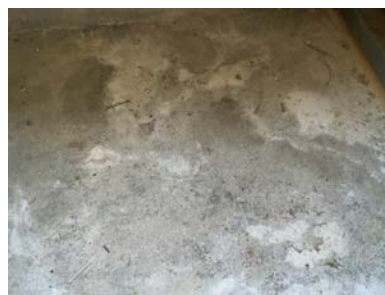
Salt/kalkutslag på gulv mot grunn grunnet fuktvandring gjennom betonggulv.
