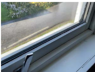
Flere vinduer lar seg ikke åpne generelt.
