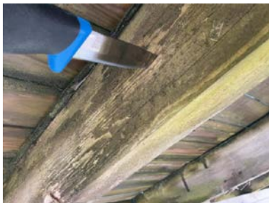
Råteskadet i bjelker/bærekonstruksjonen.
