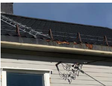
Sterk korrosjonskade på skvettblikk/snøfangerkonsoller.
