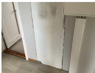
Sprekker mellom pipe/brannmur.
