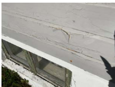
Løs overflatebehandling på deler av bordkledning.
