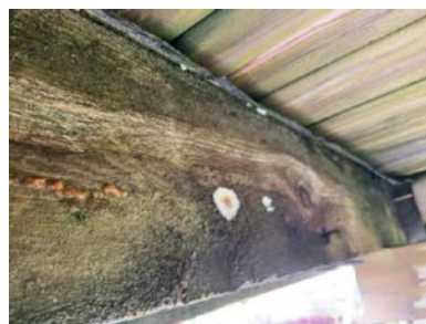
Soppangrep i bærende trekonstruksjon.
