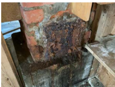
Defekt/uttett sotluke i sokkeletasjen.
