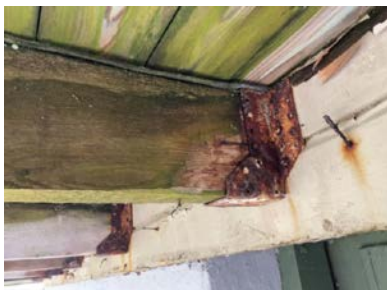
Svak innfestning av korrosjonsskadet bjelkesko i bordkledning.
