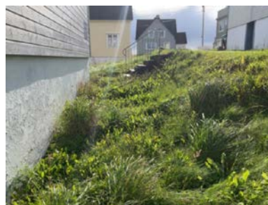
Terreng heller kraftig mot grunnmur fra kommunal vei på vestsiden.
