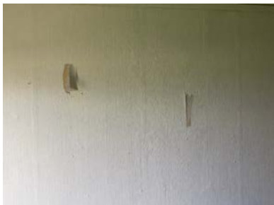
Løs/skadet tapet på i flere rom.
