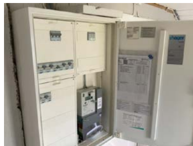
Sikringsskap på loft.
