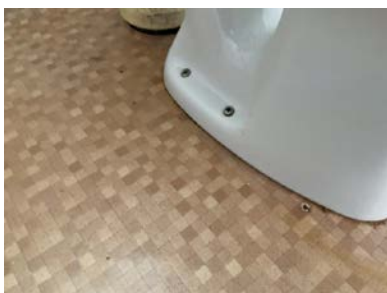
Punkttert tettesjikt ved innfestning av frittstående toalett.
