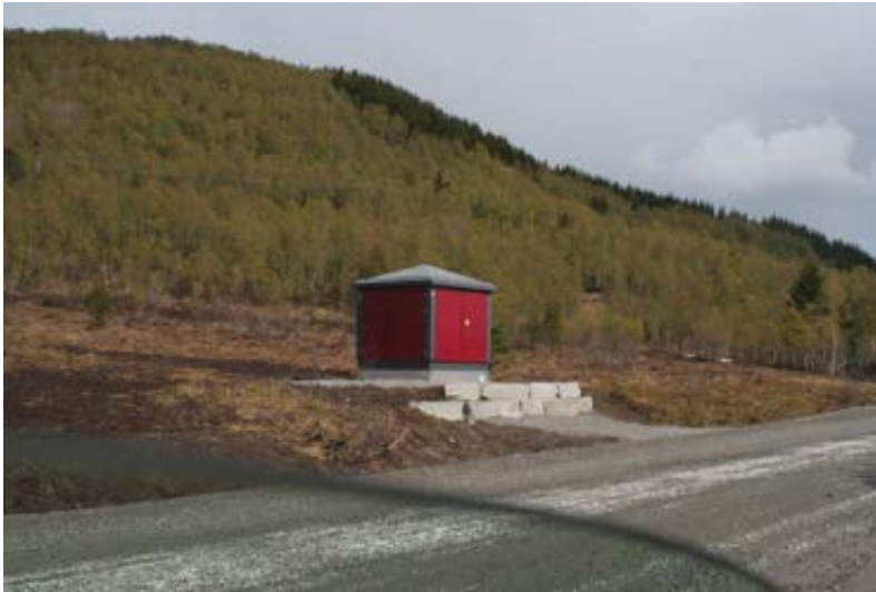
Figur 17: Trafokiosk med uheldig fargeval/materiale. Foto: A. Siejak.
