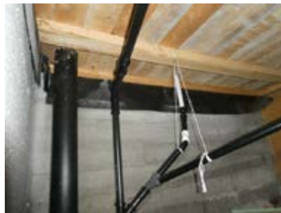
Uegnet materialer og Ikke fagmessig utført
