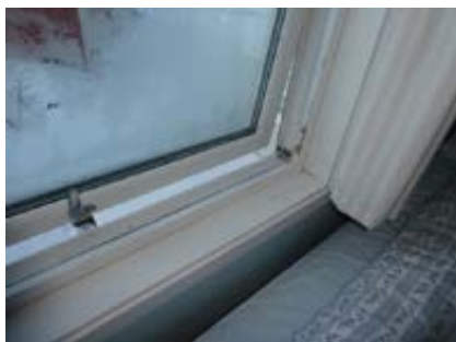
Vindu med punktert glass
