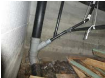
Uegnet materialer og Ikke fagmessig utført
