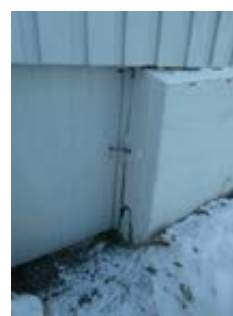
Sprekk i murpuss ved kjellerdør
