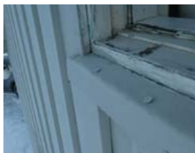
Utvendig tetting ikke helt fagmessig utført
