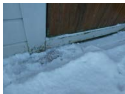
Beslag under dørterskel er ikke etablert.
