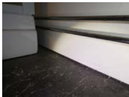
Veggplatene er ikke montert etter monterings anvisning
