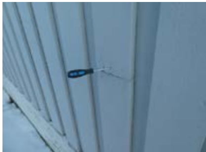
Råteskade i skjøte på kledning
