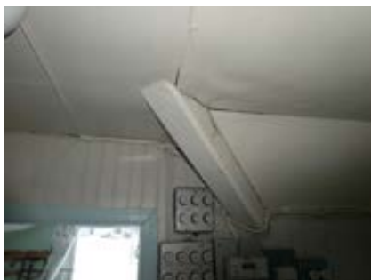
Gammel fuktskade loftsgang
