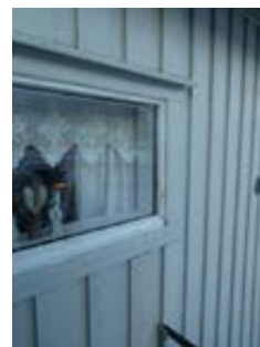
Utvendig tetting ikke helt fagmessig utført
