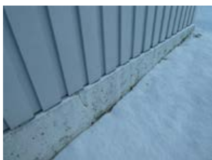
Sprekk i utvendig murpuss
