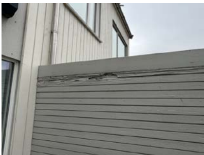
Fukt/råteskade på levegg.
