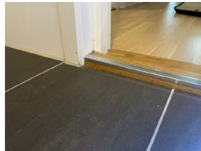
Opp-kant ved terskel med terskel-list. Dette er en ikke godkjent løsning.
