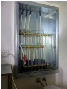
Rør i rør skap står i vaskerom. Rør- fordeling er ikke merket.
