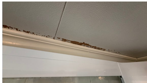
Noe merker i himlingen over dusjen
