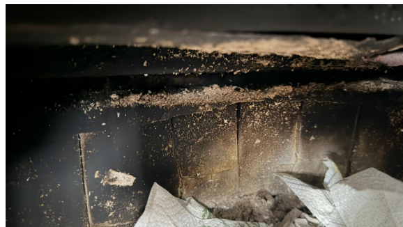
Skader på den ildfaste stenen i peisen
