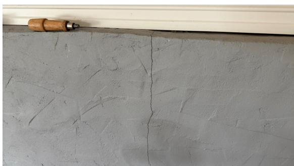
Sprekker i overflater på brannmuren bak peisen
