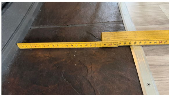
Avstanden er mindre enn 30 cm til brennbart materiale
