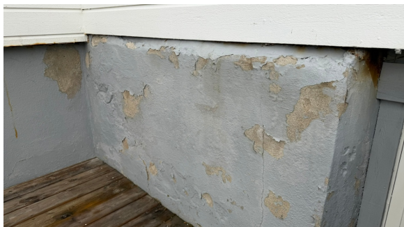
Slitasje i overflaten på grunnmuren
