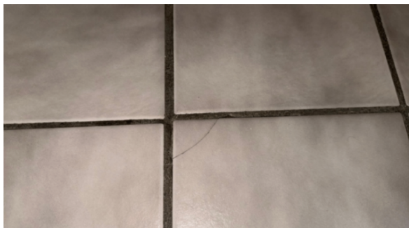
Sprekker i noen fliser på gulvet
