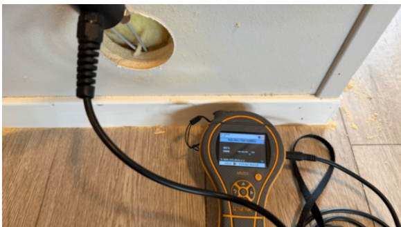
Fuktsøk i tilstøtende vegg
