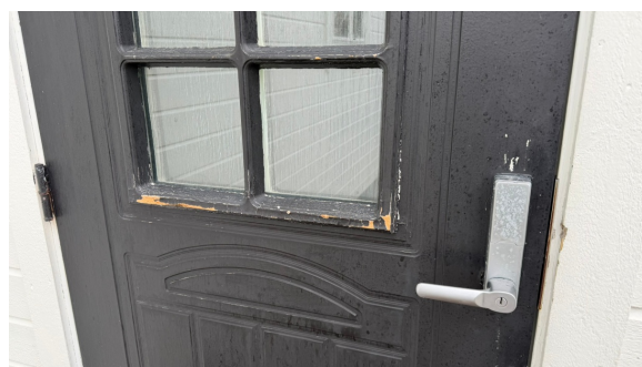
Slitasje i overflaten på ytterdøren
