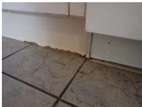
Fuktskade i sokkel.
