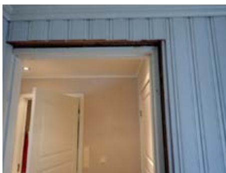
Ikke ferdigstilt med lister/foringer
