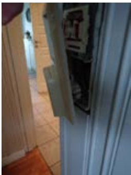
Løs deksel/el-tilkobling i trapperom
