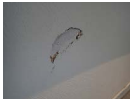
Skade i vegg plata på stua
