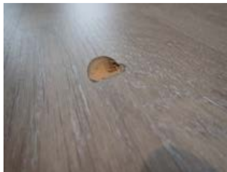
Skade i laminaten på stua
