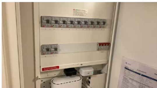
El-skap med automatsikringer
