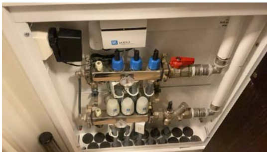
Fordelere for vannbåren gulvvarme.
