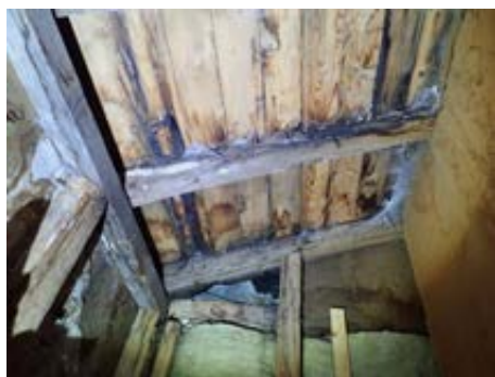
Råteskader og mugg i trobordene og takkonstruksjon i uteboden
