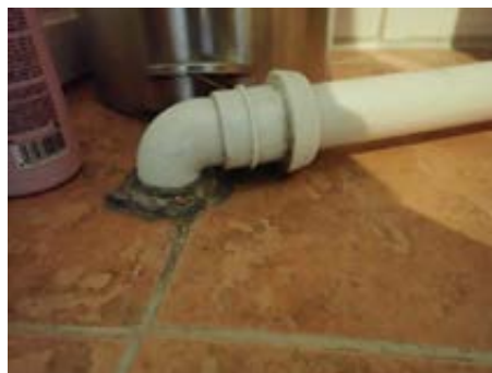
Ingen mansjett rundt avløpsrør i gulv.
