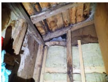
Råteskader i takkonstruksjon og i bindingsver
