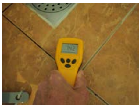
Mye fuktindikering i dusjhjørne. Her er deler av fugen borte
