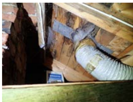
Fuktmerker i taktroa.
