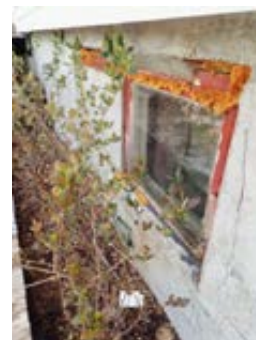
Sprekk i mur ved vindu mot terrasse
