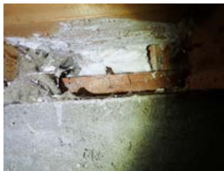
Sopp over grunnmursvi
