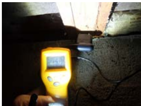
16% fukt i trebjelkelaget
