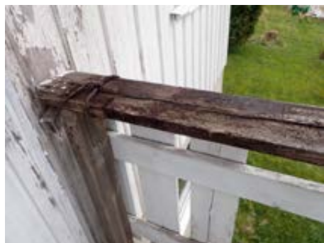
Råteskadet håndlist 1. etg.
