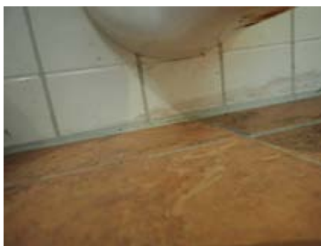
Ingen drenering under veggheng wc
