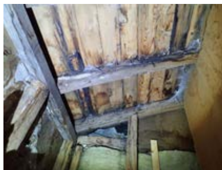
Råteskadet og mugg på sperrer og trobord.
