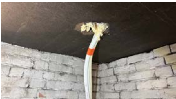
Vannledninger er løse fra hovedinntak til tak.
