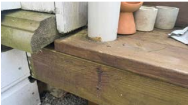
Takvannsnedløp er ikke tilkoblet drens under terreng.
