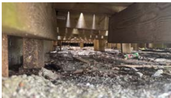
Fall eller slak helling mot grunnmur under terrasse.
