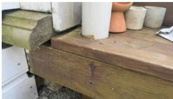
Nedløpet er ikke koblet til drenerør (slipper vannet på bakken)
