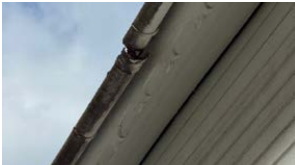
Renneskjøt er løsnet.
