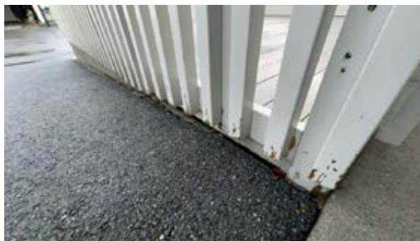
Små skader på rekkverk.
