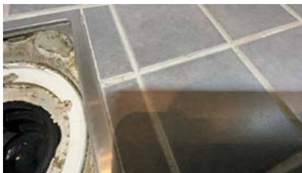
Flisfugene bør utbedres.
