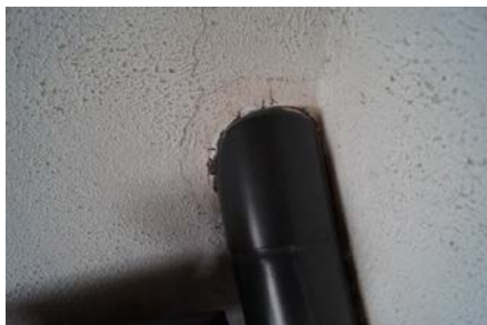
Det er registrert enkelte riss i brannmur/puss ved røykinnføringen på stue.
