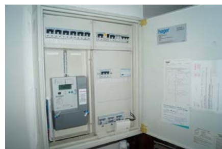
Automater i sikringsskap
