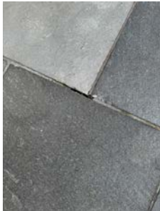
Manglende fugemasse på terrasse
