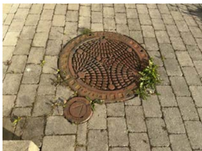
Utvendig stenge-ventil for vann og stake-kum.
