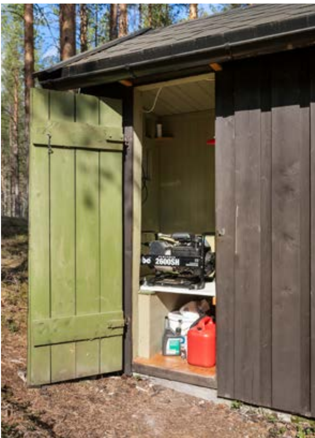
Boden har et 12-volts el-anlegg med solcelle som gir lys i boden og utelampe. Fotograf: Petter Aamodt
