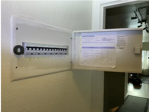
Sikringsskap står i entre.
