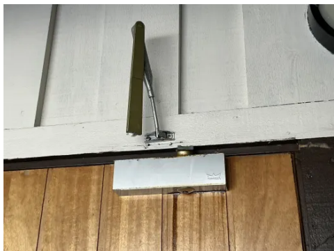
Dør-pumpe til inngangsdør er defekt.
