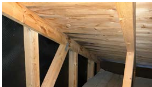
Det er observert fuktskjolder på loftet.
