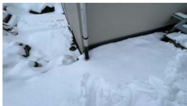
Ikke tilstrekkelig ført vekk fra mur.
