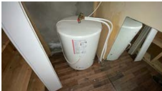
Varmtvannsbereder for leilighet i sokkel
