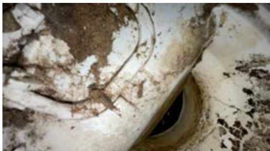
Sluk under dusjkabinett.
