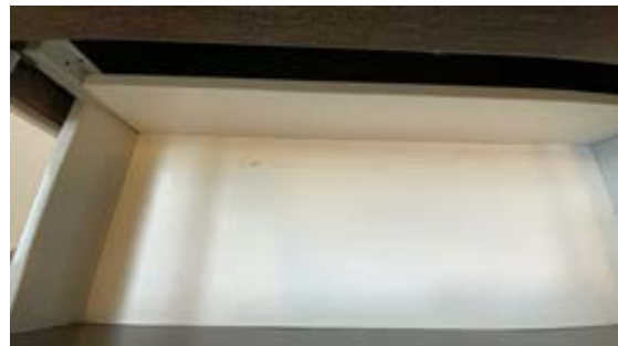
Skader/deformasjon i bunn av skuffer under vask.
