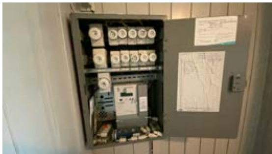
Sikringsskap i leilighet i sokkeletasje
