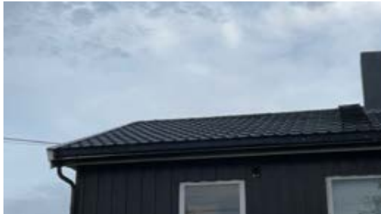
Manglende snøfangere i gangareal.
