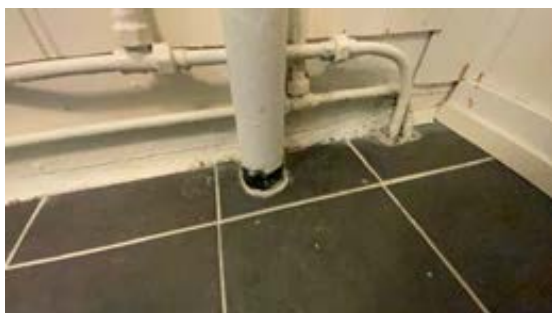
Ikke fagmessig/dokumentert tetting ved rørgjennomføring i gulv.
