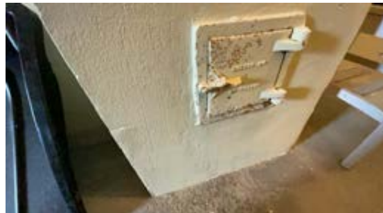
Sotluke i sokkeletasje med tilgang fra hovedenhet.
