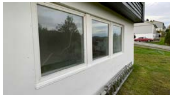
Punkterte vinduer i stue/kjøkken leilighet i sokkeletasje.
