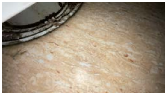
Sluk under dusjkabinett.
