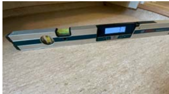
Motfall ved dør på 3 mm/meter.
