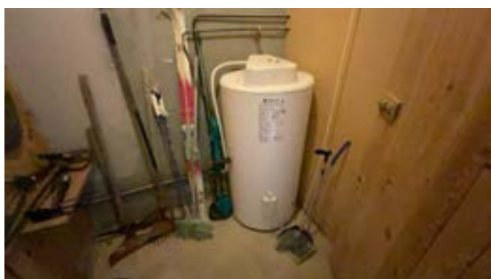
Varmtvannsbereder til hovedenhet plassert i bod sokkeletasje.
