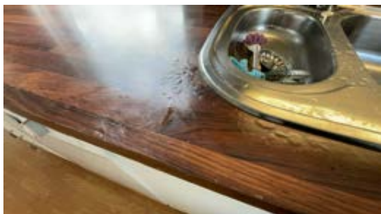
Svellskader i benkeplate ved oppvaskum,
