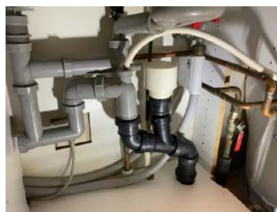
Durgo vakum lufting på 2", i kjøkken benk, kan gi uønsket kloakk-lukt.
