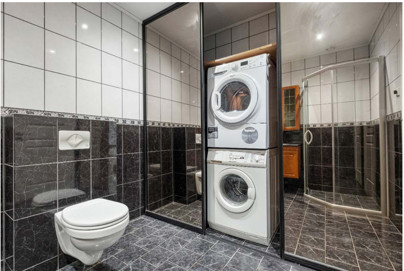
Bak skyvedører er det plassert vv-bereder, fordelerskap for vann og opplegg for vaskemaskin
