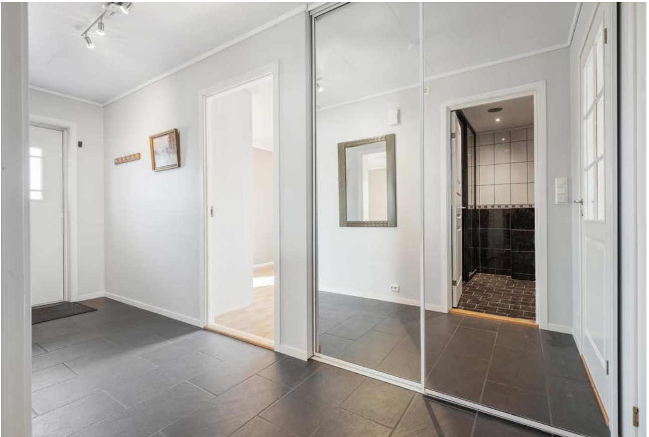
Det er varmekabler i gang
