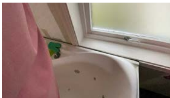
Badekar like ved vindu uten fuktsikring
