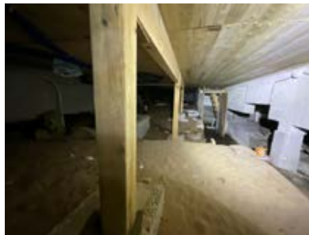
Avstiving/ ekstra støtte montert under bjelkelag.
