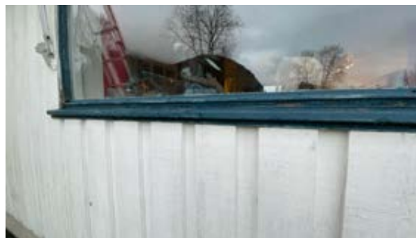
Utvendig fukt/ aldersslitasje på vindu.
