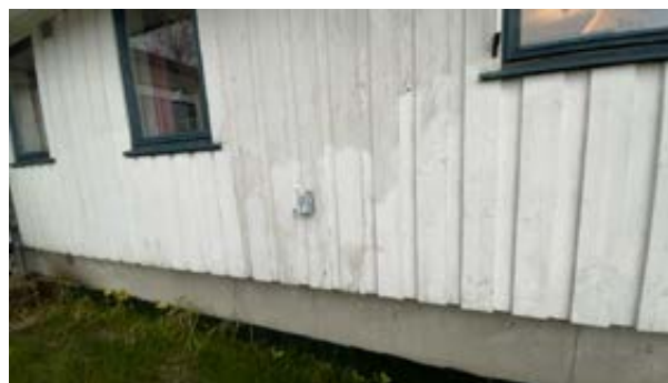
Malingsbehandling på kledning er svært slitt.
