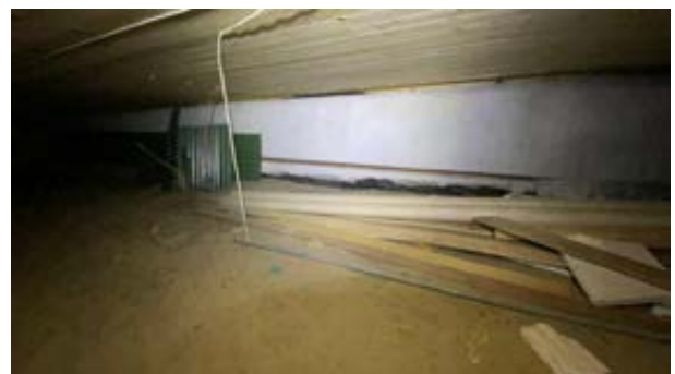
Ringmur i betong. Masse seget vekk fra mur mellom søylepunkter. Søylepunkt synlig
