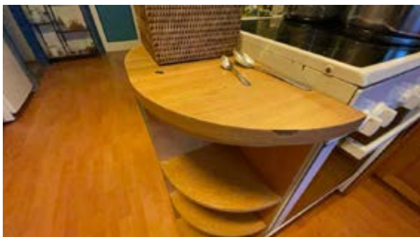
Synlig skade på benkeplate.
