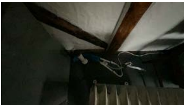
Vanntilførsel til spiserom ved inngang uten tetting.
