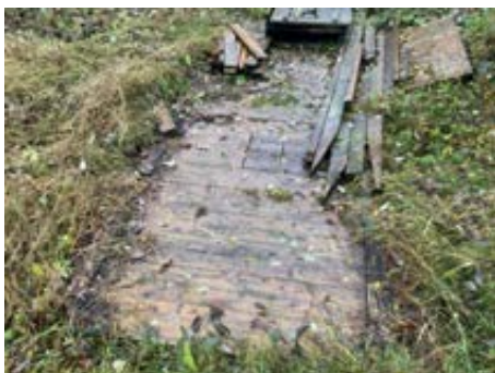
Lokk av tre på septiktank
