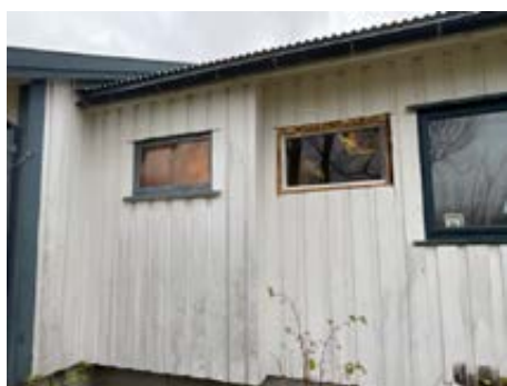
Midtre vindu mangler beslag/ tilslutning til kledning.
