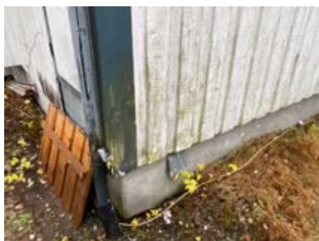
Godt synlig grønske/ sopp på vegg
