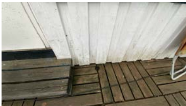
Bord med sprekkdannelse ved balkongdør.
