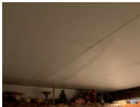
Synlig fuktskade i tak
