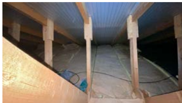
Manglende lufting ved takfot.
