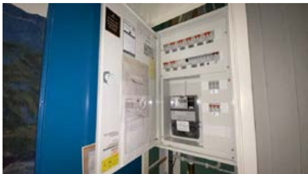
Sikringsskap i gang
