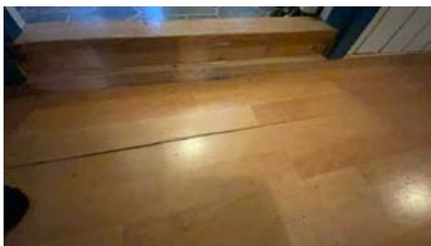
Gang: svikt mellom bordene i laminatgulvet.
