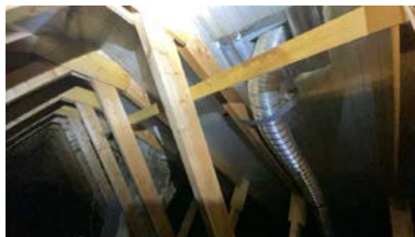
Undertak mangler tilslutning til takgjennomføring
