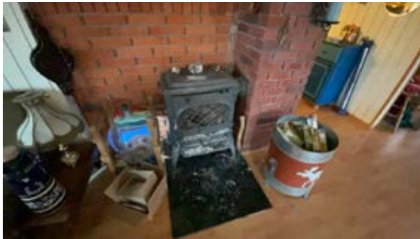
Vedovn tilkoblet pipe i stue
