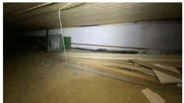
Krypekjeller med sandgulv uten fuktsperre.
