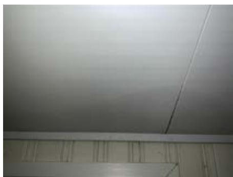
Fuktsvelling i takplater, tilbygg stue
