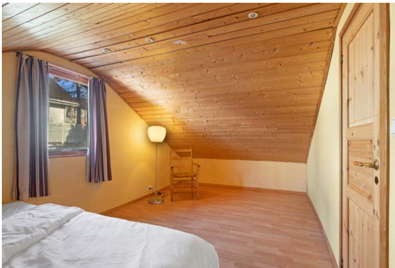
Rom brukt som soverom 2. Ikke godkjent oppholdsrom
