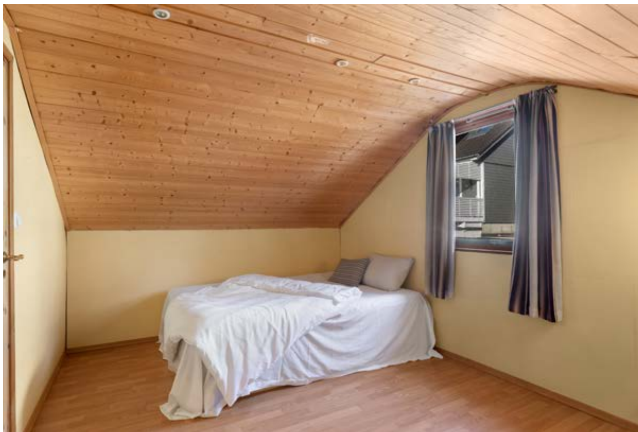
Rom brukt som soverom 2. Ikke godkjent oppholdsrom
