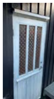
Værslitasje bi-inngangsdør mot bod/aggregat
