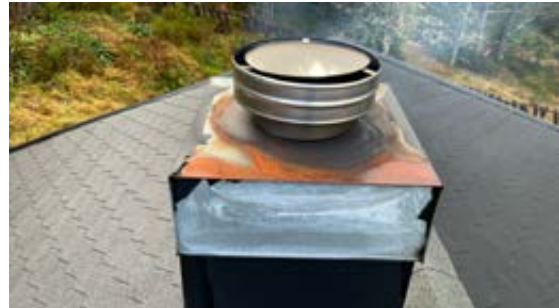
Pipekledning/pipehatt, avflassing og korrosjon
