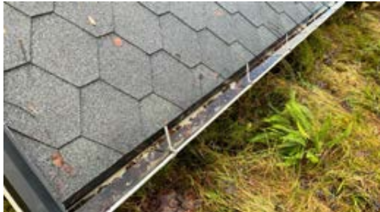
Takrenne står med vann
