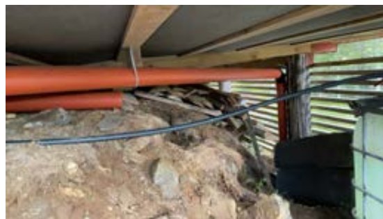
Deler av rørøpplegg
