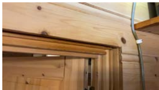
Eksempel gjenstående arbeid
