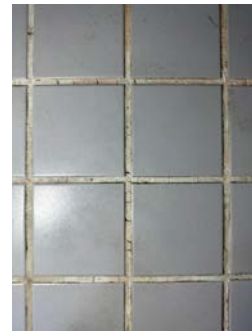
Sprekker i flisefuger på vegg og gulv.
