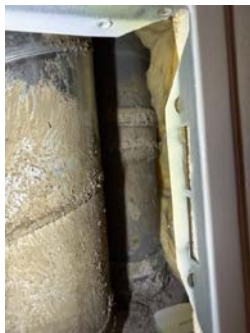
Plast avløpsrør bak luke i stue 7 etg
