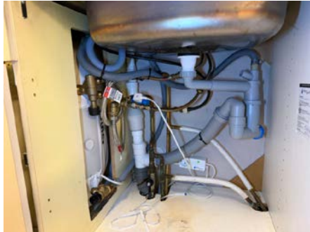
Kobberrør samt stoppekraner i kjøkkenbenk, 7 etg
