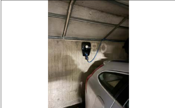
Parkering nr 80 med elbillader
