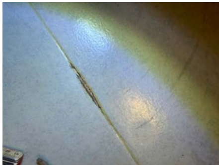
Brudd i gulvmembran/belegg fra 1988
