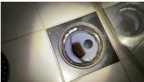
Plastsluk bad underetasje sør
