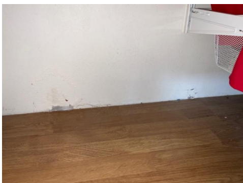
Avflasset maling ned mot gulv.
