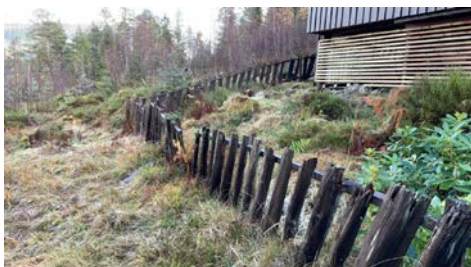
Gjerde i dårlig forfatning
