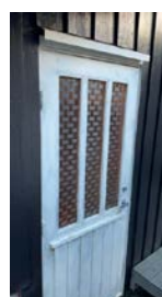
Værslitasje bi-inngangsdør mot bod/aggregathus
