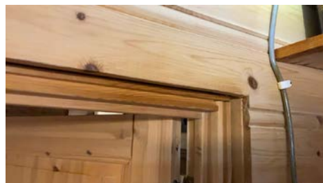
Eksempel gjenstående arbeid
