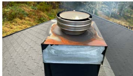
Pipekledning/pipehatt, avflassing og korrosjon
