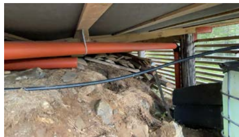
Deler av røropplegg
