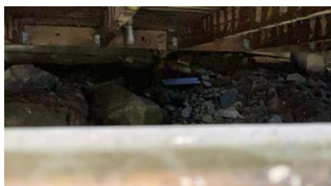
Noe tegn til undergraving grunnmur hjørne ved inngang, nedløp avslutta like ved
