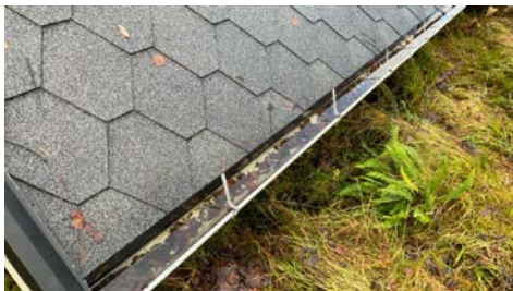
Takrenne står med vann
