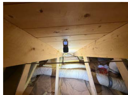
Fuktmåling i undertak, ikke utslag på fukt.
