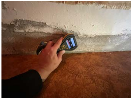
Referanse måling. Utslag på fukt på vegg ned mot gulv, ikke utslag på fukt i øvre del av vegg. Forsterker teorien om kapillært oppsug fra grunn.
