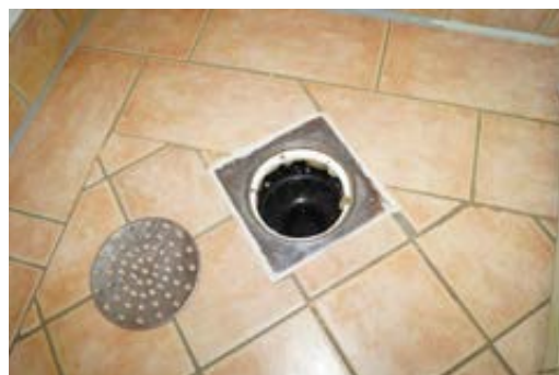
Sluk i dusjen på baderommet
