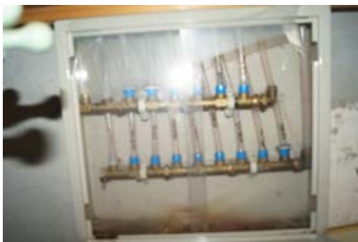
Fordelerskap vannrør plassert i kjeller
