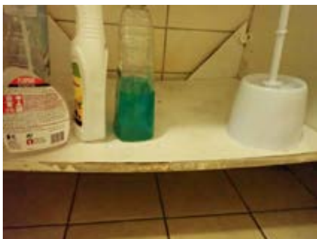
Vannskadet bunnplate i servantskap
