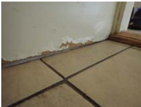
Fukt/vannskader i dør-foring
