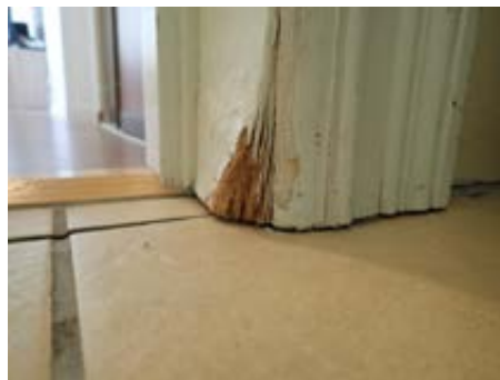
Fuktskader i foring + listverk
