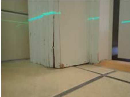
Fuktskade i foring + listverk
