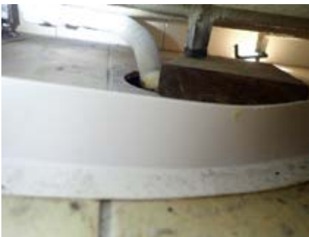
Sluk under dusjkabinett
