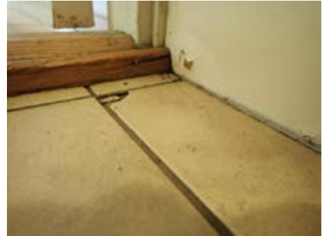
Fukt/vannskader i dør-foring + skade i flis.
