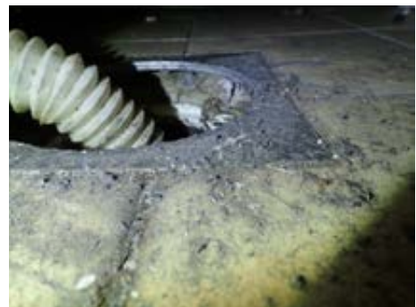
Sluk under dusjkabinett
