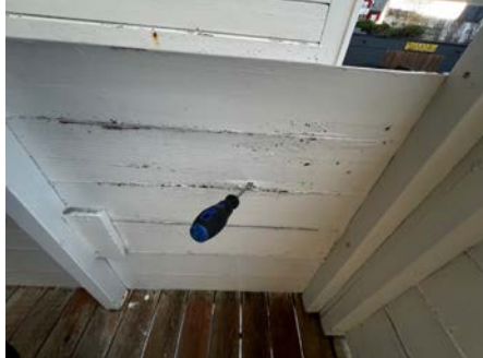
Eksempel på råteskader.
