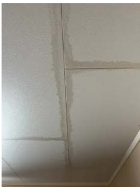
Tidligere fuktskade i himling i tilbygg
