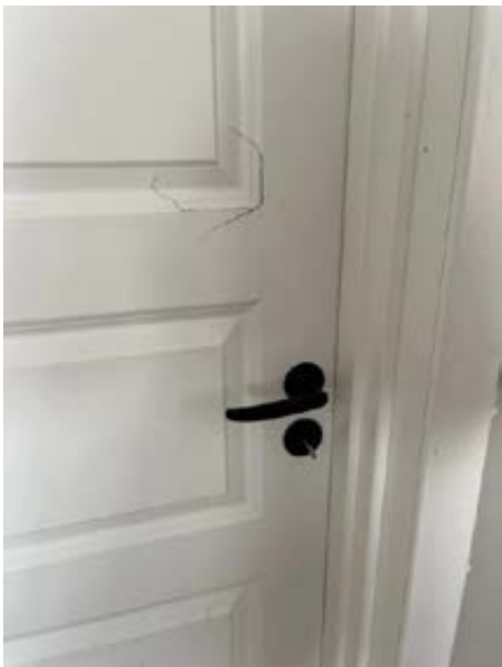
Skade på innerdør
