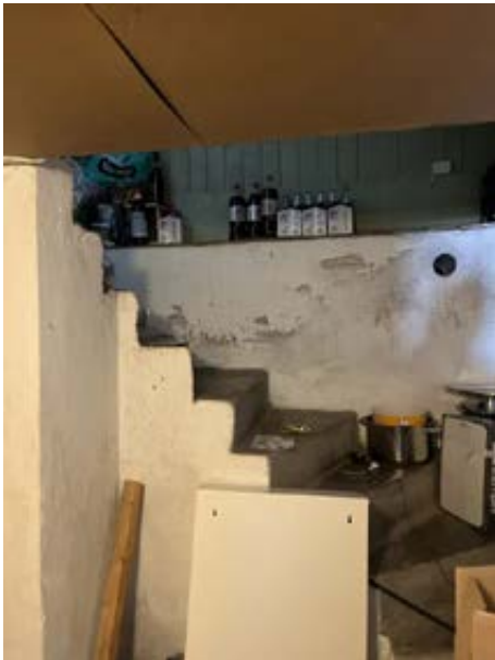
Manglende rekkverk og bratt trapp
