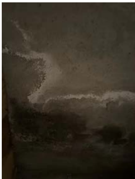
Indikasjon på fukt etter saltutslag i kjeller
