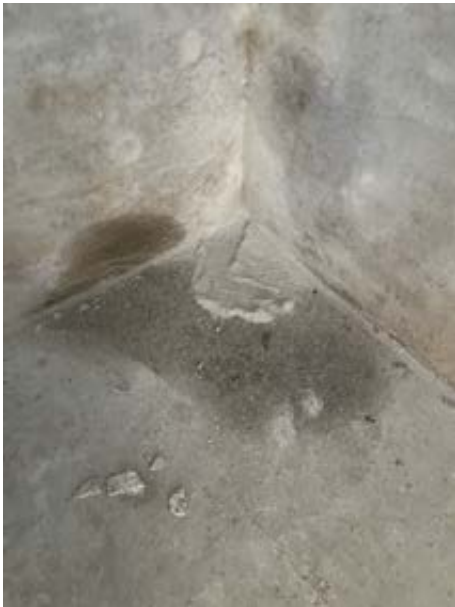
Indikasjon på fukt i kjeller
