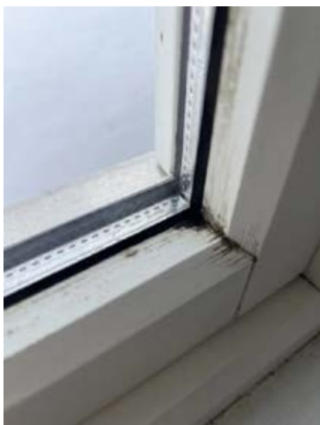
Liten råteskade i karm grunnet dårlig ventilering av rom benyttet som soverom i 2.etasje.
