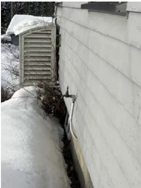
Utekran i kobber har en høy risiko for at fryser.
