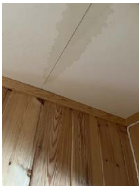
Tidligere fuktskade i himling i tilbygg
