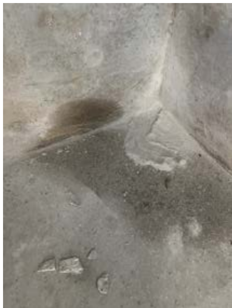
Indikasjon på fukt i kjeller
