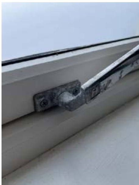
Tegn på fuktighet grunnet dårlig ventilering av rom benyttet som soverom i 2.etasje.
