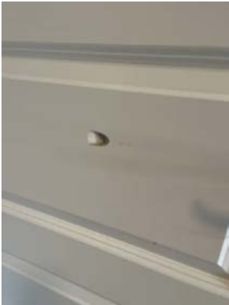
Skade på innerdør
