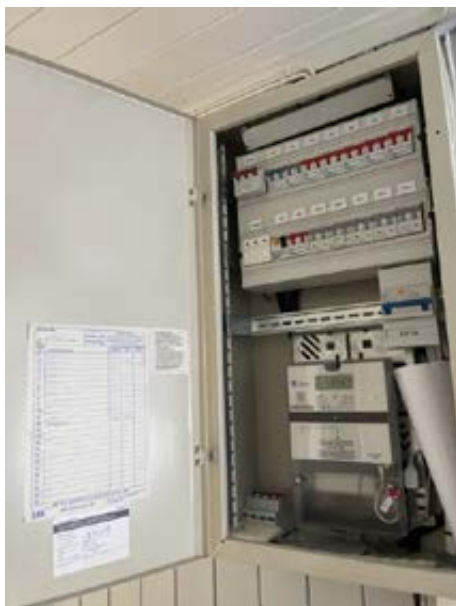
EL-skap med automatsikringer
