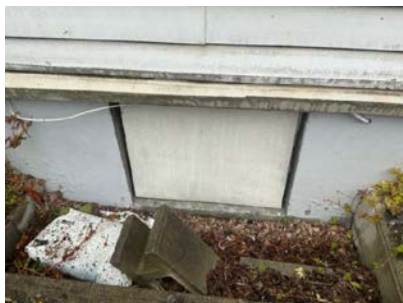
Vindu i kjeller med knust glass er dekket med plate på utside. Bytte av vindu må påregnes.
