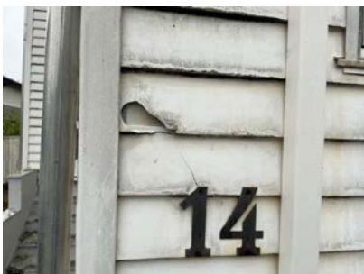
Skade på ytterkledning.
