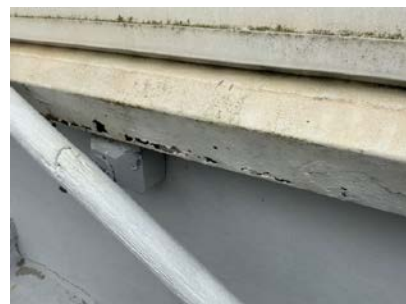
Rust/korrosjon på beslag.
