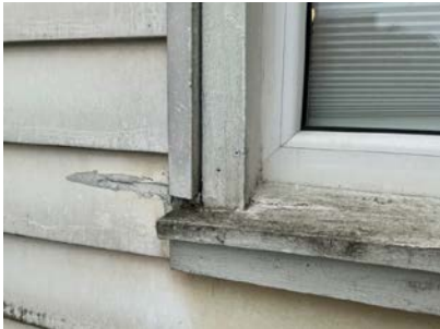
Skade på ytterkledning.
