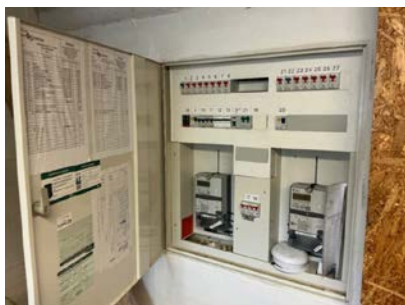
Sikringsskap står i felles kjeller.
