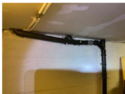
Motfall på del av avløpsrør.
