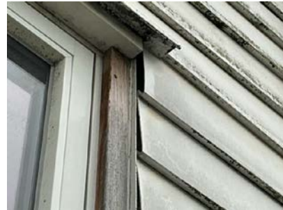
Utvendig omramming er ikke fagmessig utført og kan ikke forventes å være tett.
