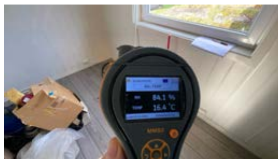
Det ble målt ca. 84 % luftfuktighet ved dagens befaring i stue.
