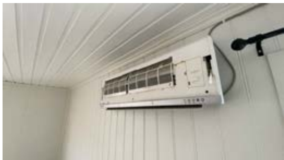
Innvendig luft til luft varmepumpe på stue
