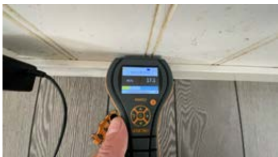
Det ble målt 17,1 vekt% fukt i mdf plater på vegg i stue.
