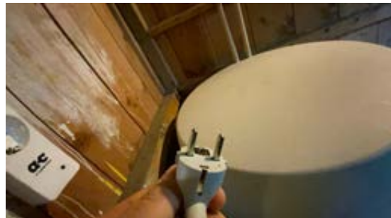
Ingen synlige brennmerker på stikk.
