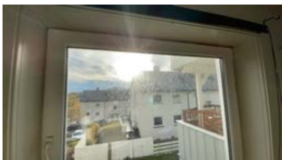
Manglende spalteventiler i vindu eller ventiler i vegg.
