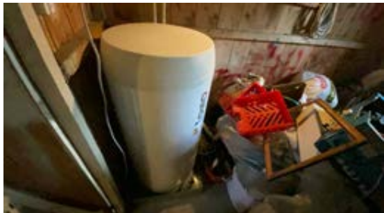
Varmtvannsbereder plassert i kjellerbod mot nordøst.
