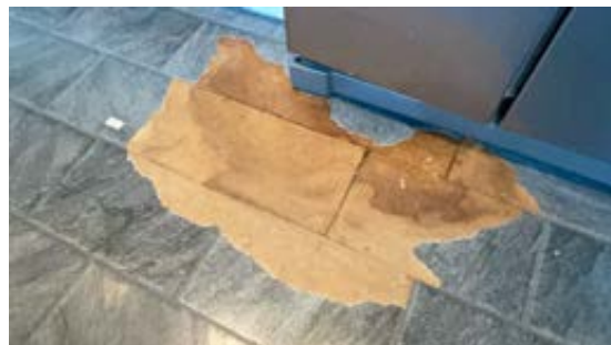
Vann/fuktskade ved kjøleskap på gulv mot kjeller.
