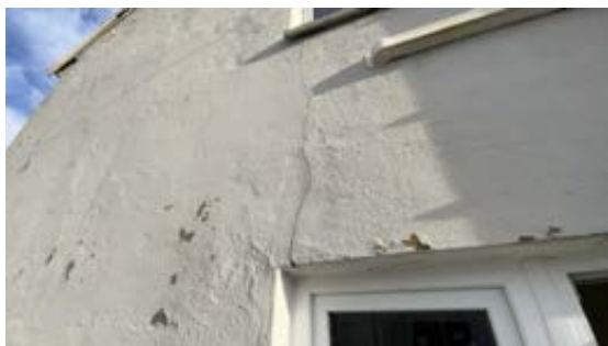
Riss/avflassing og overflatebehandling.
