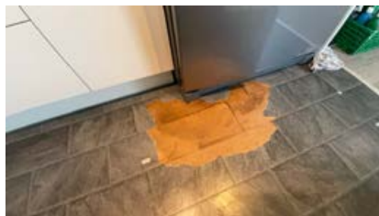
Fuktskade på kjøkkengulv.
