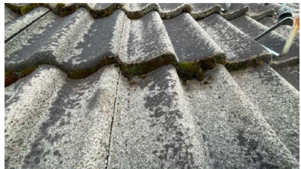
Mose på taket og takstein er slitt.
