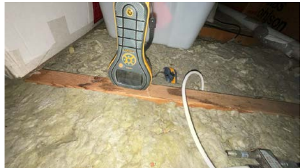
Tørr fuktskjolde på loftet.
