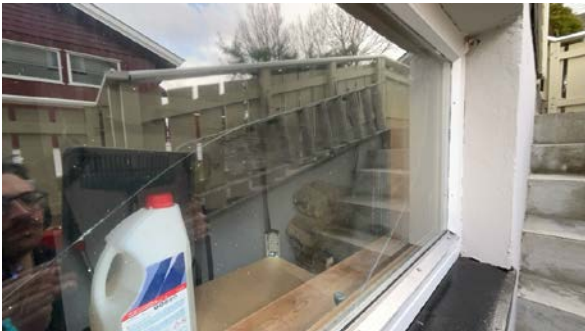
Sprekk i glass på vindu.
