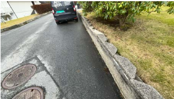
Muren har skjevheter og løse steiner.
