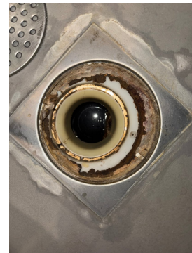
Eldre sluk. Misfarging på mikrosementen rundt slukristen.
