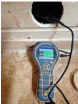
Målt 15,6 % i bunnsvill utforingsvegg mot mur
