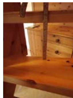
For stor åpning mellom opptrinn
