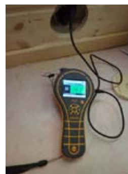
Målt 14 % i bunnsvill treverk i vegg mot vaskerom
