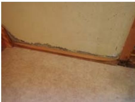
Fukt /avskallet maling ved golv malt murvegg i trapperom
