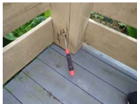
Råteskade i rekkverkstolpe
