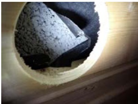
Viser tørt i vegg
