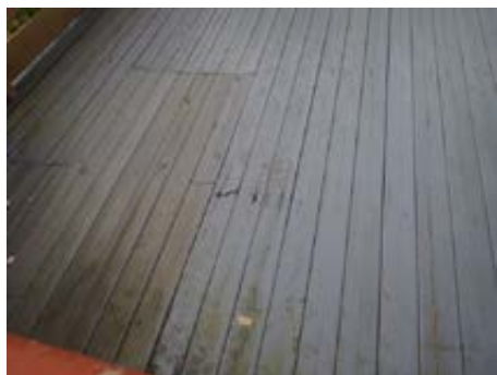
Stedvise råteskader i tredekke.
