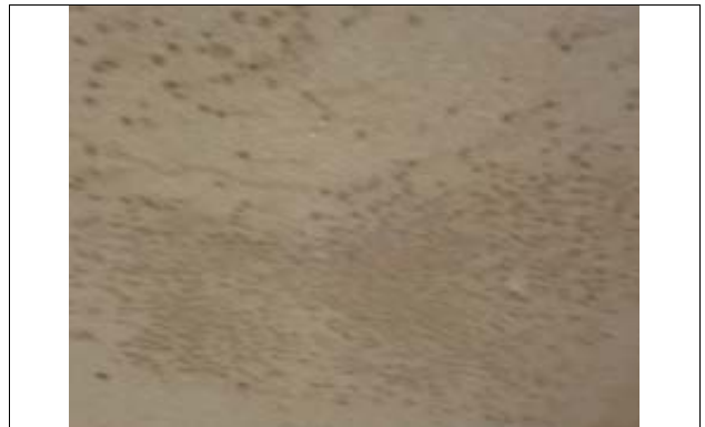
Bilde viser fuktmerker/utslag til bordtak grillhus
