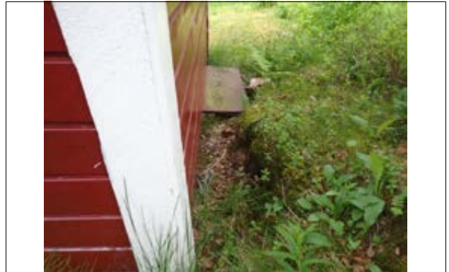
Bilde viser at uthus m/ utedo er nært til terreng med fuktighet til masser og bekk/ veit like ved.
