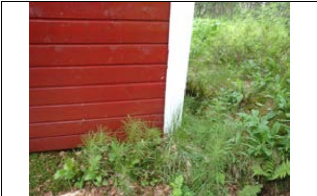
Bilde viser sig/ skjevhet til utedoet, nært til terreng og bekk/ veit
