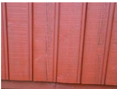
Bilde til deler av kledning som viser riss, sprekker (mindre)
