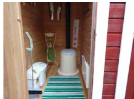
Bilde tatt mot utedo etablert i uthus. Avtrekk over tak, panelovn på vegg. Mindre åpningsvindu etablert
