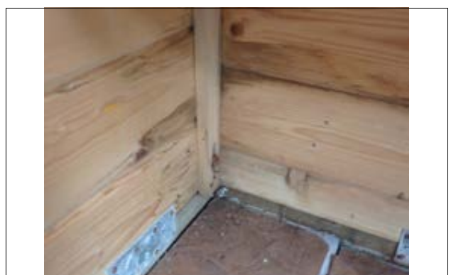
Annet bilde viser fukt merker i grillhusets vegger
