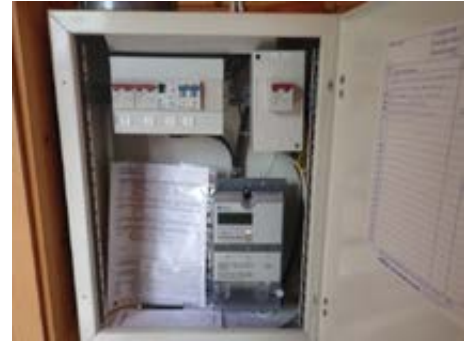
Bilde tatt inn mot sikringsskapet automatsikringer, fjernavlest måler
