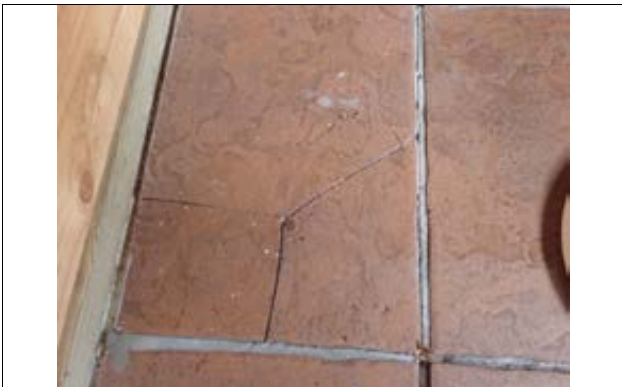
Bilde viser dels sprukne fliser i rommer, er flere fliser som har sprukket, løs og manglende fuging mellom og til fliser
