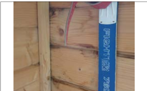
Fuktmerker til veggarealer i grillhuset flere steder
