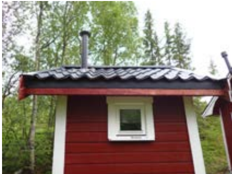
Bilde viser avtrekk fra utvendige utedo m/ avtrekk over tak.
