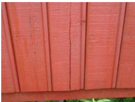
Bilde til deler av kledning som viser sprekke og riss, sprekker på bordkledning
