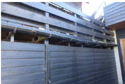
Skadet takrenne, med motfall
