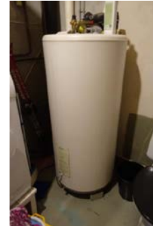
Varmtvannsbereder i vaskerom
