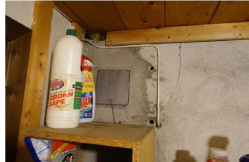
Ventil mot yttervegg på østveggen
