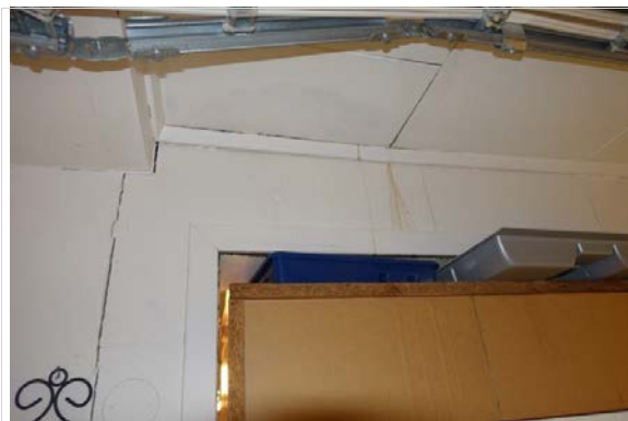
Lekkasje fra taket (tett sluk er utbedret)
