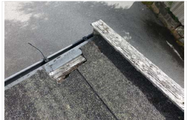
Råte v/vindski og avrevet papp
