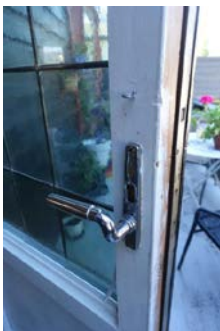
Ødelagt espagnolettlås på dobbel balkongdør
