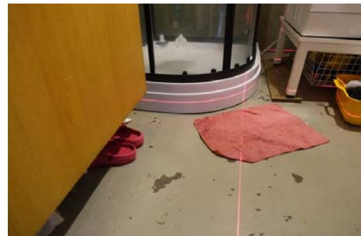
Sluk antas å ligge under dusjkabinett
