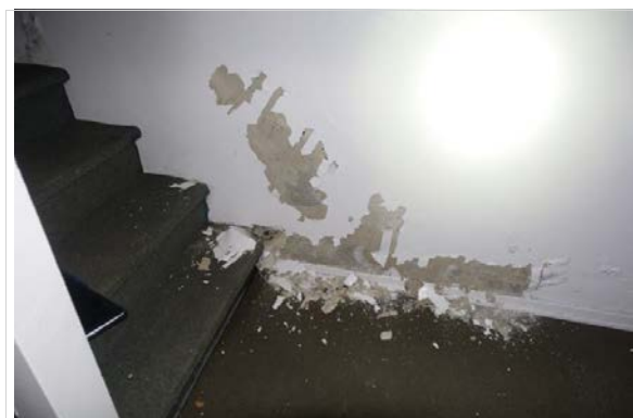
Fuktgjennomgang på ringmur ved scenetrapp
