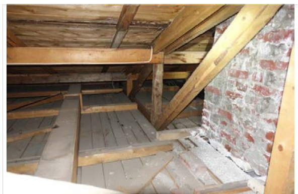
Fuktmerker og saltgjennomslag v/pipe
