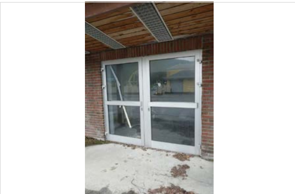
Knust glass i ytterdør
