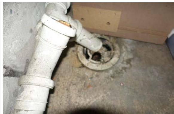
Eldre ødelagt slukrist
