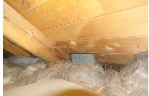
Dårlig lufting over isolasjonen ned mot raftene
