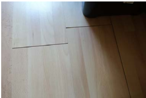
Laminat med store fuger, sov øst
