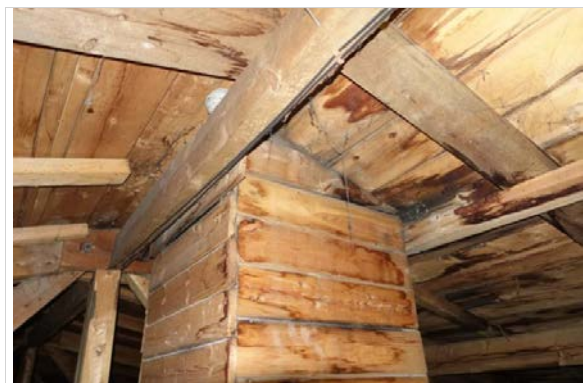
Fuktgjennomgang ved luftelyre
