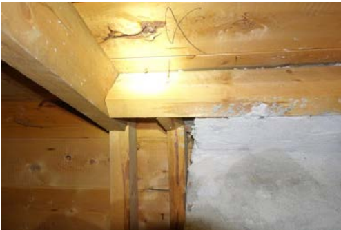
Tørre forhold ved pipegjennomføring
