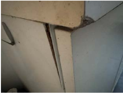
Skade på hjørne av benkeplate og en front
