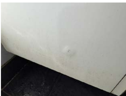
Tegn til svelling på siden av baderomsinnredning
