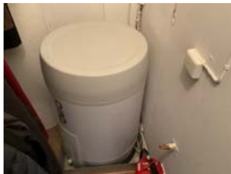
Varmtvannsbereder i kott.
