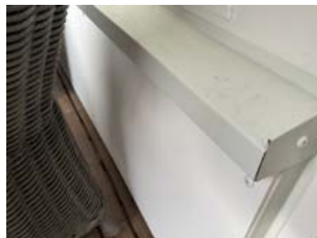
Vindusbeslag i nedre del av vindu.
