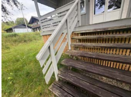
Råteskader i rekkverk.
