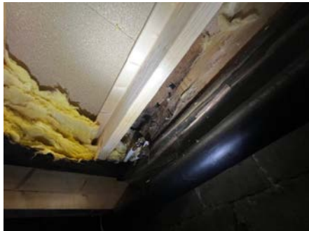
Trolig skyldes skadene lekkasjer fra vannledninger. (Disse bilder ble tatt den 17.06.2025)
