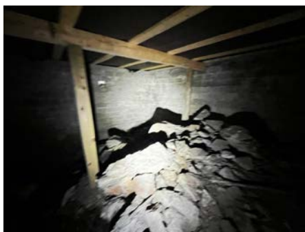
Fuktskader i etasjeskiller, synlig i fra krypkjeller.
