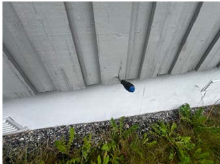
Råte på vestegg.
