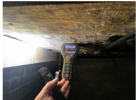
Fuktskader i etasjeskiller under bad. (Disse bilder ble tatt den 17.06.2025)
