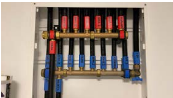
Fordelerskap med rør i rør opplegg
