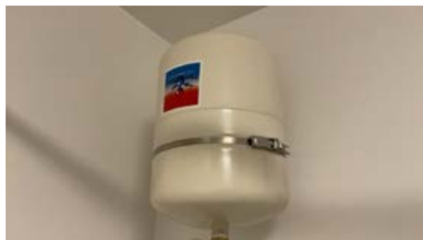
NB ! Ekspansjonstanker bør ha jevnlig service.
