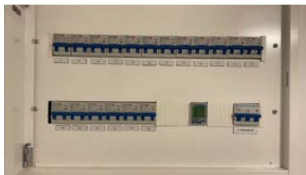
El-skap med automatsikringer
