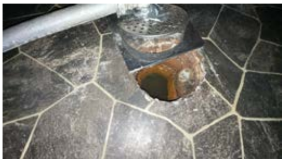
Eldre støpejernssluk hvor tettesjikt ikke går under klemring eller lignende.
