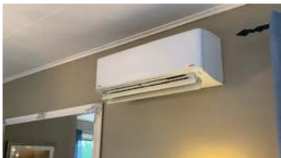
Varmepumpe på vegg i stue 1. Etasje.
