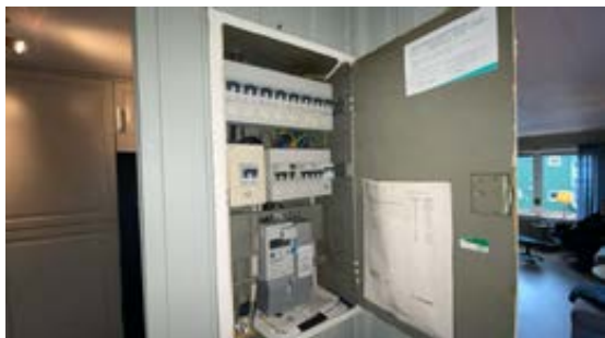
Sikringsskap i gang med trapp i 1. Etasje.
