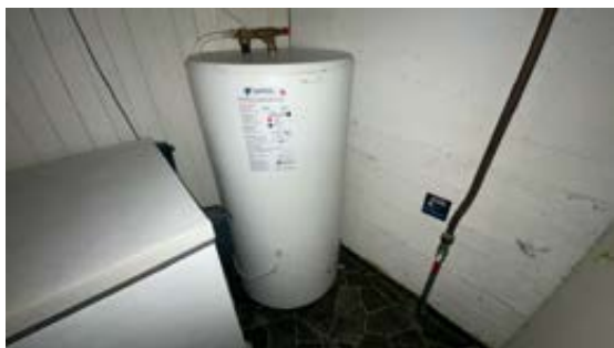
Varmvannsbereider i vaskrom.
