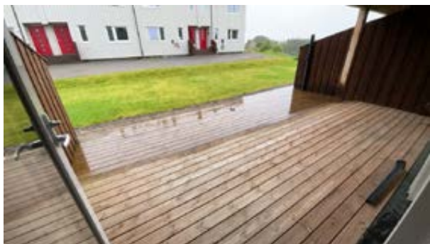
Markterrasse som er delvis overbygd.
