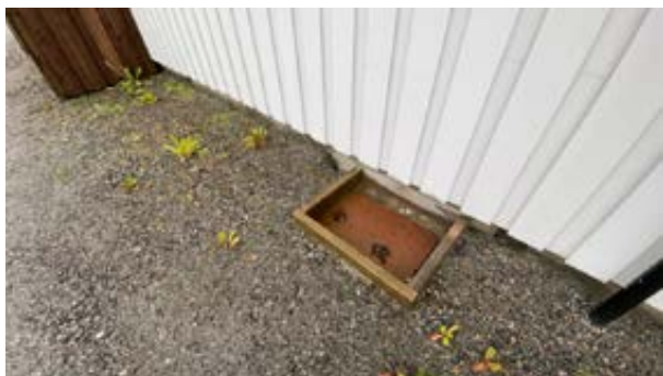
Luke ved leilighet lot seg ikke åpne grunnet manglende håndtak.
