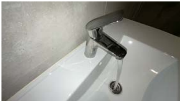
Løst armatur på vask.
