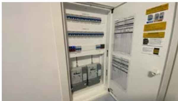
Sikringsskap plassert i felles gang/trappeareal.
