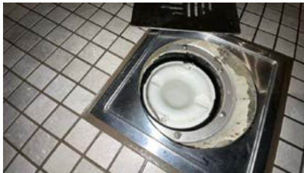
Plastsluk med tegn på tettesjikt ved klemring.
