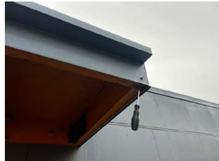
Berørt område med råteskader.
